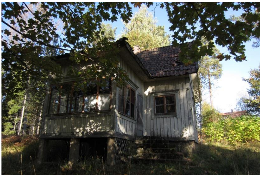
Kuva 24. Hylätyt vanhat rakennukset voivat toimia lepakoiden päiväpiiloina tai lisääntymisyhdyskuntina, jotka ovat laissa suojeltuja. Siksi ne on syytä tarkistaa ennen purkua. SP
